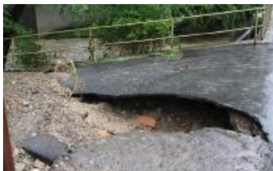
Botič 2013, Praha – Hostivař, škody po opadnutí vody
